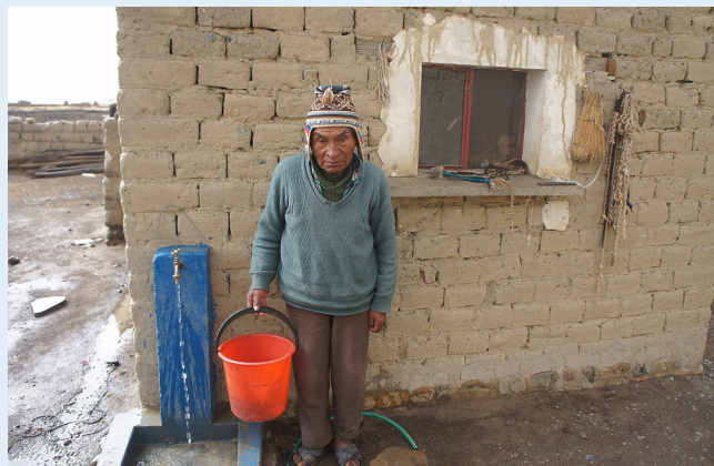
In Quillu Javira gibt es dank dem Projekt Diakonie im Andenhochland inzwischen Leitungswasser und sanitäre Anlagen. Foto: LWB/I. Dorji
