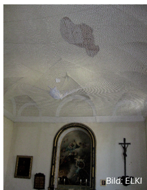
Die Schäden an der Decke der Kirche sind offensichtlich.
