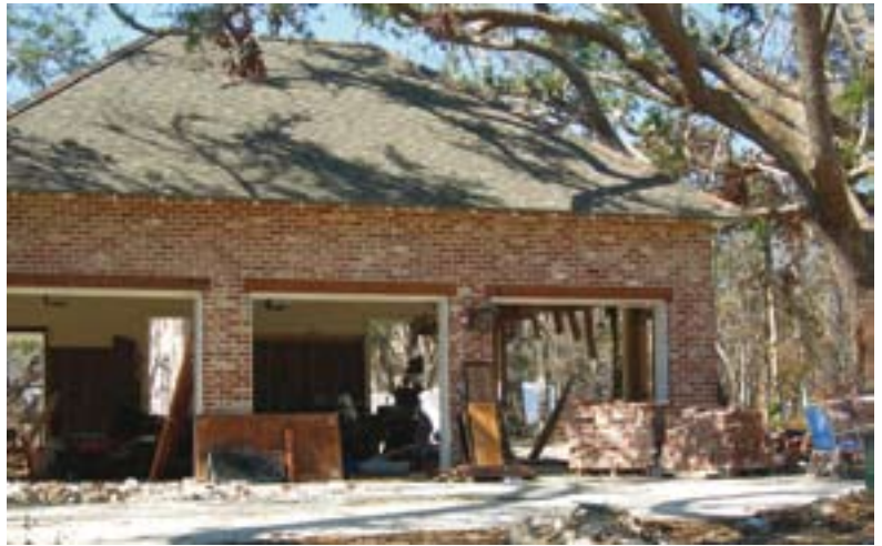
In Ocean Springs (Mississippi/USA) hatte der Sturm eine solche Wucht, dass er die verstärkte Betonwand dieser Garage durchbrach. © ELKA/M. Nevergall
